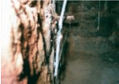
Hibás beépítés A fallal történő érintkezés következtében korrodált alumínium vezető
